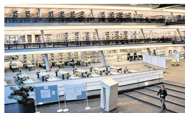
Dank der Installierung von LED-Leuchten wird nicht nur Geld gespart, das Licht in der Unibibliothek ist auch angenehmer. FOTO: PETER BINDER
